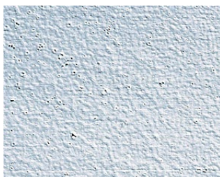
Dažyto paviršiaus defektas
