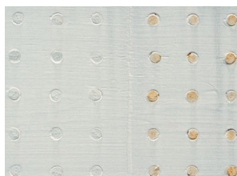
Dažyto paviršiaus defektas
